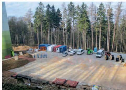
Abb. 27. Beim Bau von Windenergieanlagen im Wald geht der Flächenbedarf weit über den Fundamentgrundriss des Turms hinaus. Aufnahme aus Rheinland-Pfalz, D. Bölsterli.
